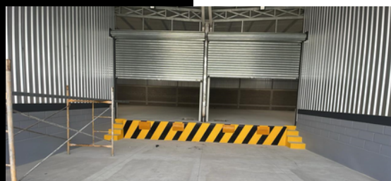
Cortinas de carga y descarga
