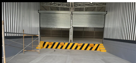
Cortinas de carga y descarga
